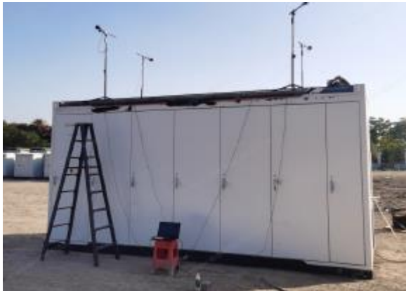
Abbildung 8-2, Batteriespeichercontainer Power Titan 2.0 (Auszug aus Noise Report)
