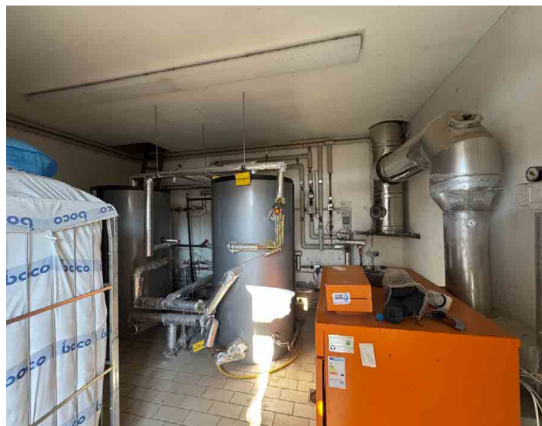
| Abb. 43 Heizungsraum in neuen Sanitärgebäude
