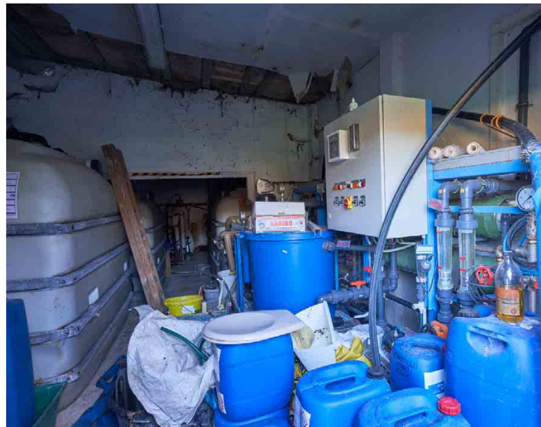
| Abb. 73 Chemikalienlager in einer der Bauruinen am Grundstück
