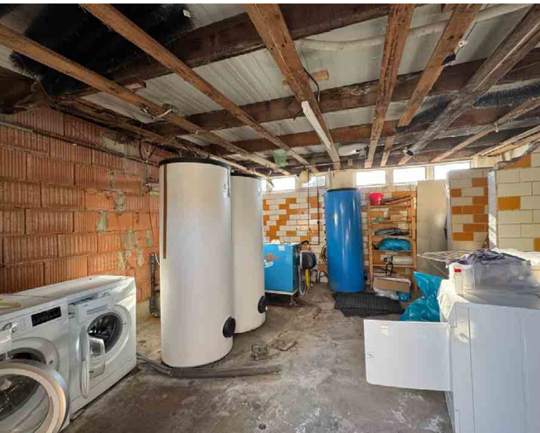
| Abb. 45 Wasch- und Technikraum im alten Lagergebäude
