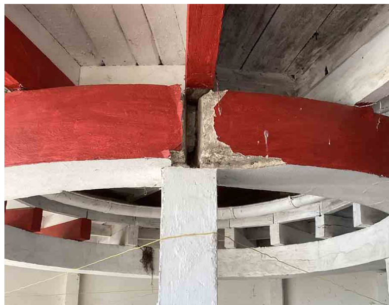
| Abb. 70 Schadfal an Tragstruktur Betonring
